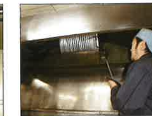
試運転確認 (風量測定)
