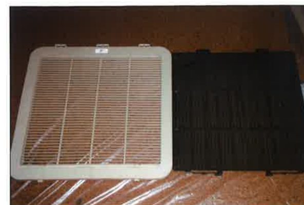
吸込グリル・フィルター洗浄前
