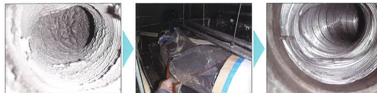
一般排気ダクト(フレキシブル)清掃前 一般排気ダクト(フレキシブル)清掃中 一般排気ダクト(フレキシブル)清掃後
