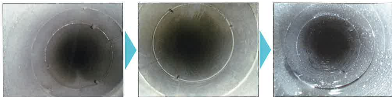
小口径・スパイラルダクト清掃前 小口径・スパイラルダクト清掃後 小口径・スパイラルダクト清掃後トリートメント
