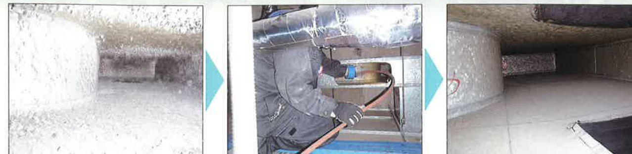
一般排気ダクト清掃前 一般排気ダクト清掃中 一般排気ダクト清掃後
